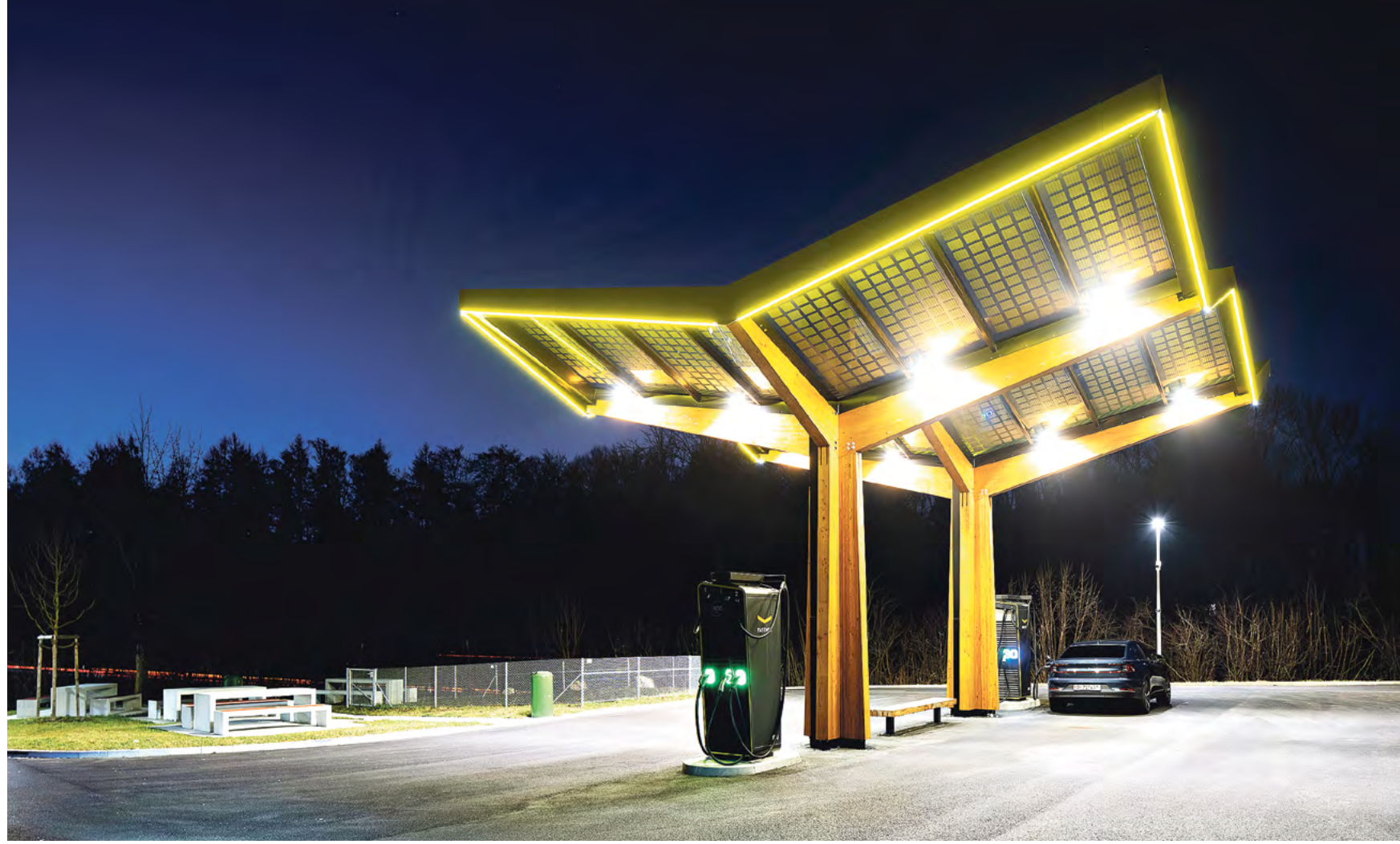
Station de recharge super rapide avec capteurs solaires dans une aire de repos près de Lenzburg, sur l'A1. La station peut recharger jusqu'à quatre véhicules en même temps, et fournit en quinze minutes de quoi rouler jusqu'à 300 kilomètres. (25 JANVIER 2022/GAËTAN BALLY/KEYSTONE)
